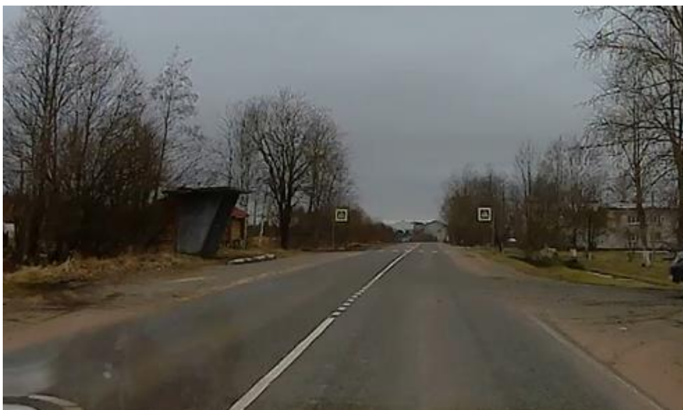
Рисунок 2.7.1.2 – Отсутствует знак 5.16 «Место остановки автобуса и (или) троллейбуса» на остановочном пункте в соответствии с ГОСТ Р 52766-2007 (с. Шум)
