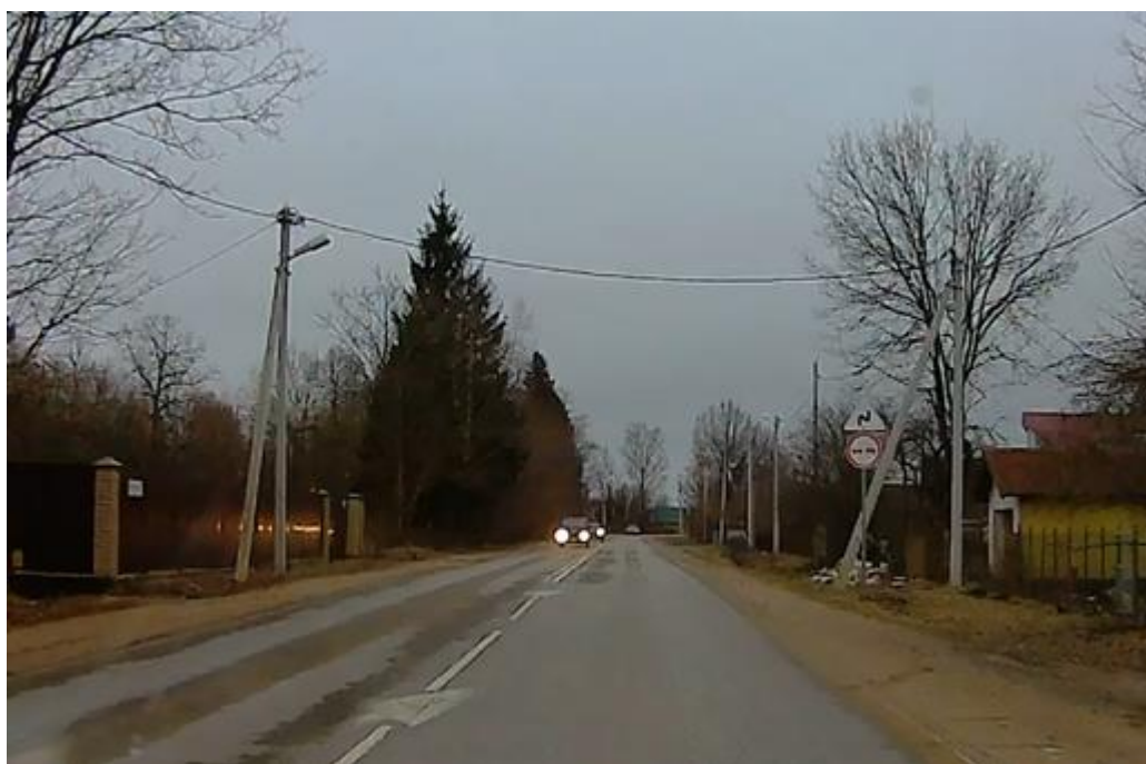
Рисунок 2.7.1.4 – Эксплуатационное состояние 1.12.1 «Опасные повороты» не соответствует требованиям ГОСТ Р 50597-2017 (пгт. Назия)
